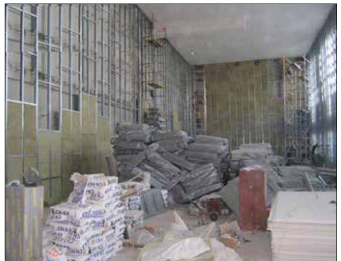
Suspension des cloisons avec des EP+SYLOMER.
