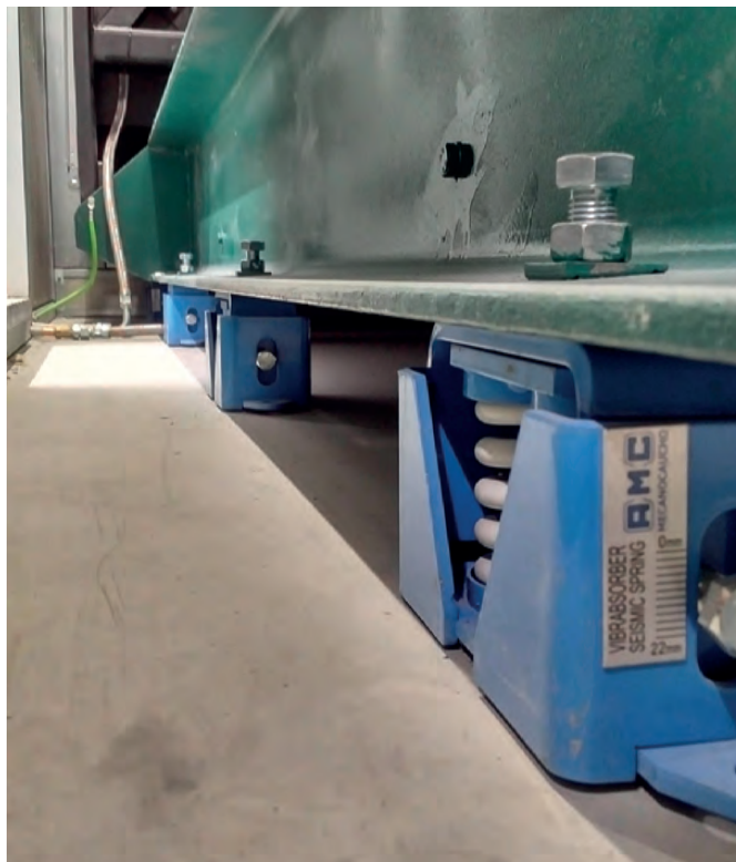
Compresseur isolé avec VIBRABSORBER + Sylomer®
